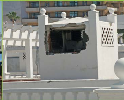
ACABADOS. Mal estado de la cubierta y fachadas, con balastradas, chimeneas, pérgolas y pavimentos fisurados e incompletos.
