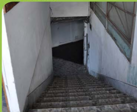
CIRCULACIÓN VERTICAL. Escaleras mal dimensionadas y trazadas, falta de claridad en el recorrido entre plantas.
