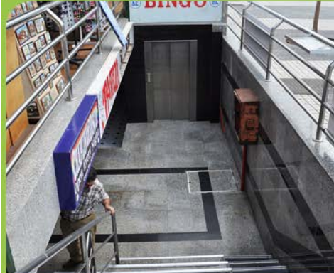
CIRCULACIÓN VERTICAL. Ascensor con acceso a través de escalera. Incumplimiento de altura mínima de cabezada en escaleras.
