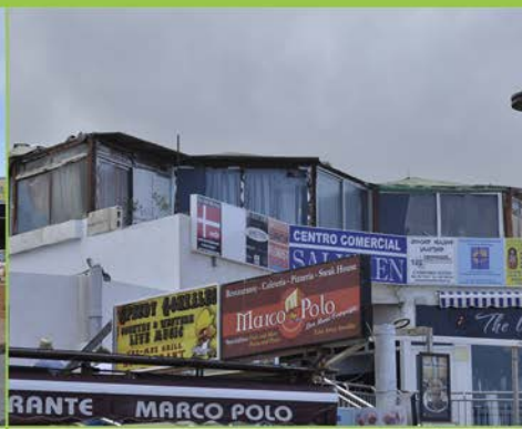
ACABADOS. Autoconstrucciones en cubierta de muy baja calidad constructiva y estética en la fachada marítima.
