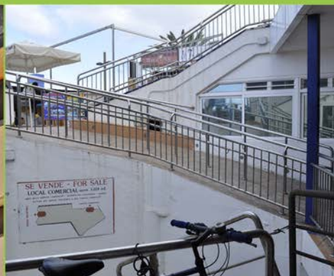
ACCESIBILIDAD. Rampas mal dimensionadas en los accesos, discontinuidad del recorrido adaptado, ascensor fuera de la parcela.
