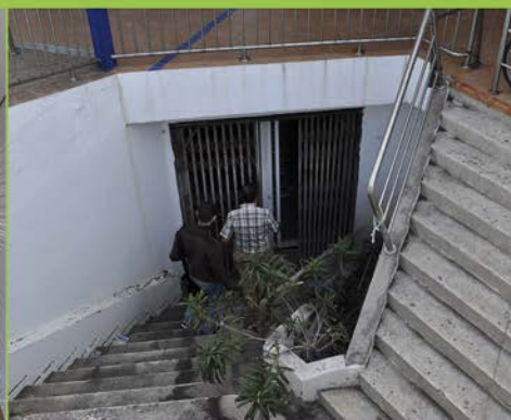
CIRCULACIÓN VERTICAL. Acceso a sótanos por escaleras mal dimensionadas.
