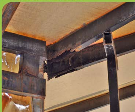
ESTRUCTURA. Estructuras metálicas con graves problemas de corrosión por exposición a ambiente marino.
