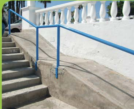
CIRCULACIÓN VERTICAL. Escaleras sin revestir y mal dimensionadas, rampas de excesiva pendiente y falta de ascensores.
