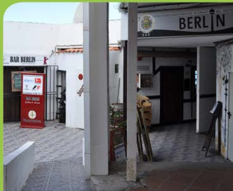
ESTRUCTURA. Estructura metálica con problemas de corrosión por alta exposición a ambiente marino y falta de mantenimiento.
