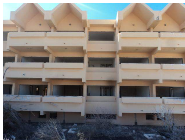
Edificación en estado de abandono en Corralejo
