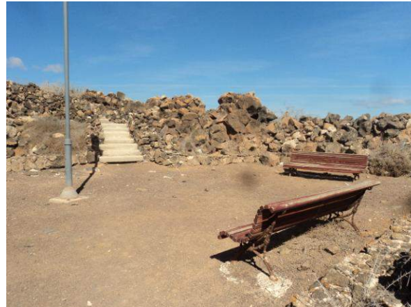
Bancos en mal estado de conservación
